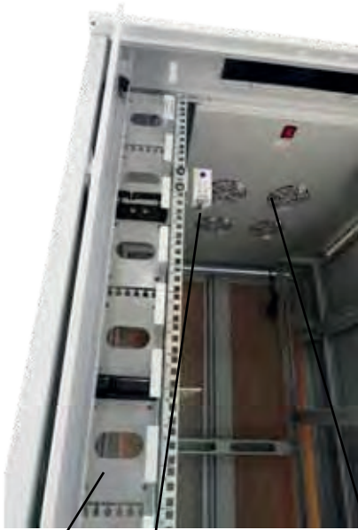
Kabelkanal, Temperatureinheit, Lüfter
