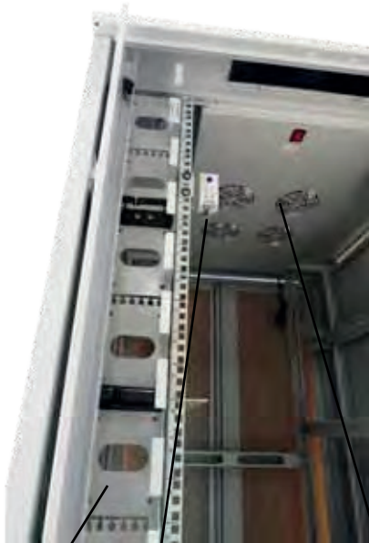
Kabelkanal, Temperatureinheit, Lüfter
